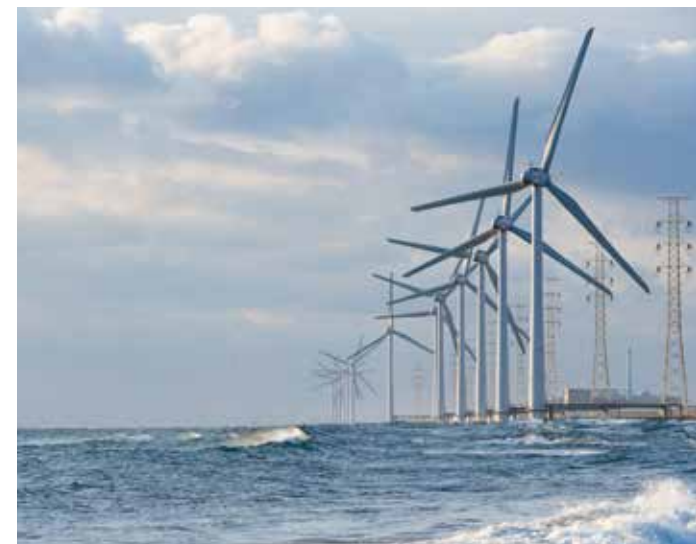
ウインドファーム ウィンドパワーかみす第2洋上風力発電所
